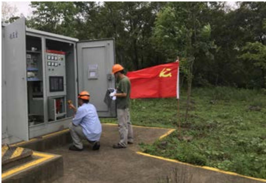
台风“利奇马”登陆前夕，龙源江苏公司各风电场开展特殊巡视，排查故障隐患。
